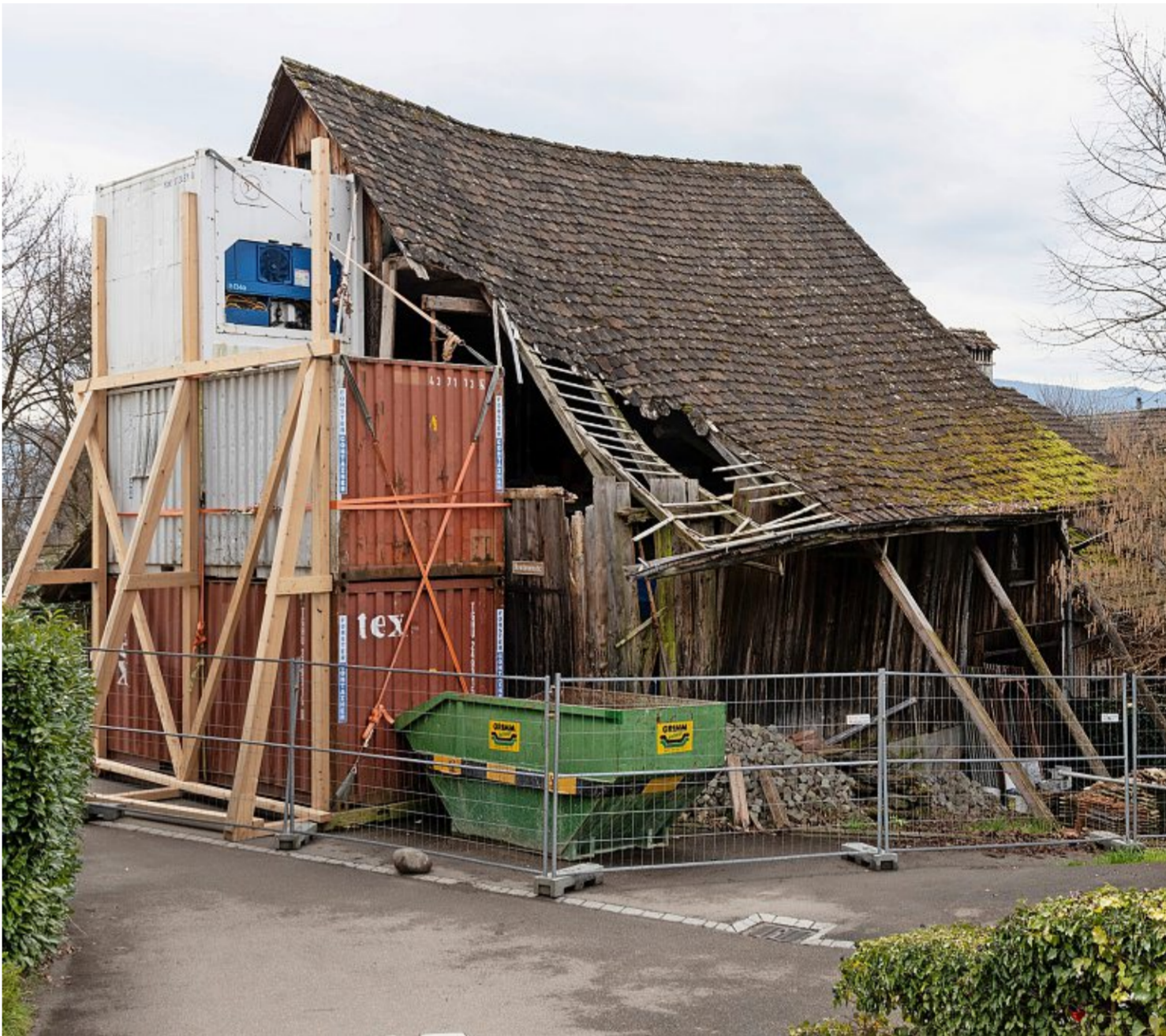
Seit dem letzten Sommer fehlen Teile des Dachs und der Fassade. Zudem ist die Scheune von Pilz und Schädlingen befallen. Foto: Sabine Roock
